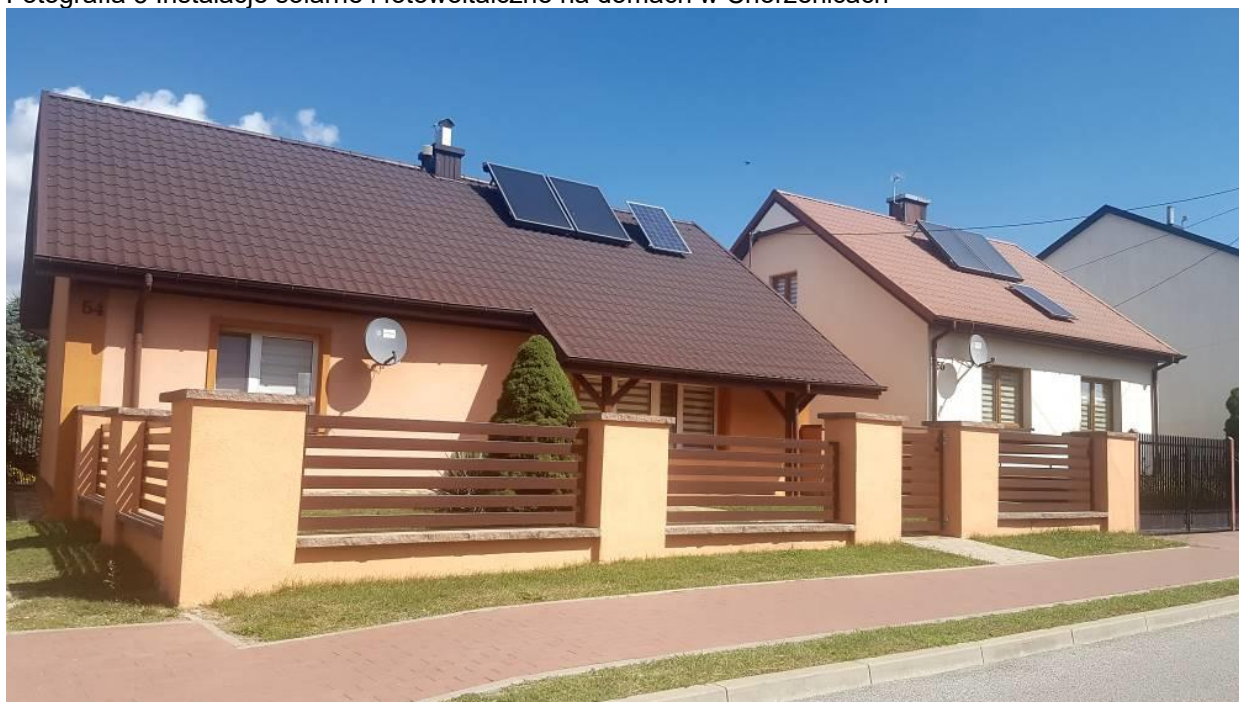
Fotografia 3 Instalacje solarne i fotowoltaiczne na domach w Chorzenicach
